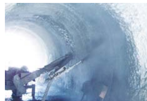
模擬トンネルで行う吹付け試験 開発した低アルカリセメント HFSC424を実際に作った模擬のトンネルで使用。この吹付け作業で無事に確認試験を終え、次に幌延の地下坑道で実証試験を行う。
